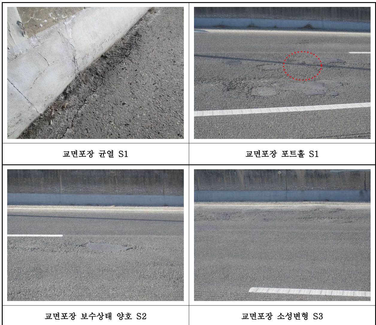
【사진 1.3.18】 교면포장 손상현황
