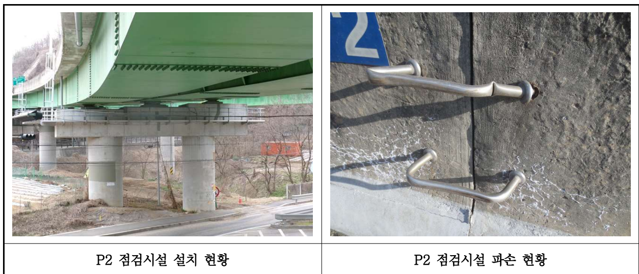
【사진 1.7.3】 점검시설 설치현황
