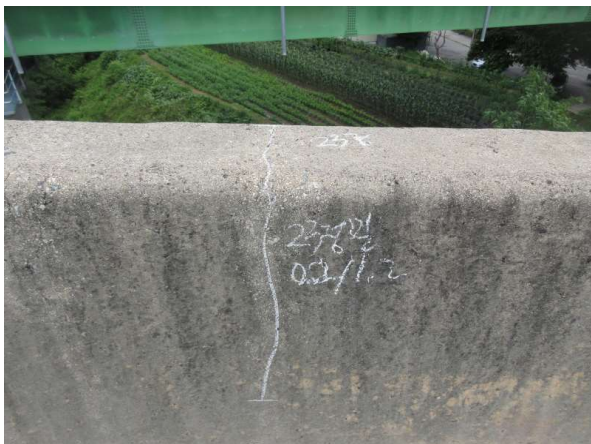
방호벽 균열 (0.3mm미만) S1
