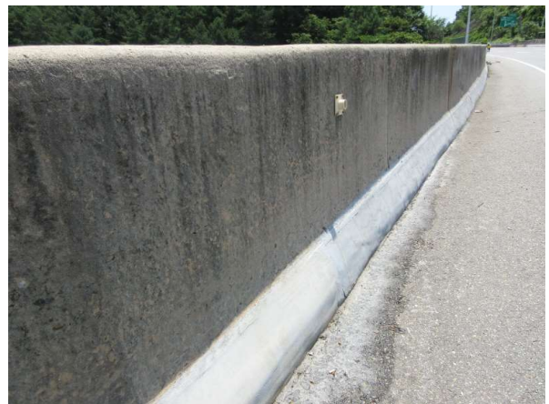
방호벽 델리네이트 파손 S2
